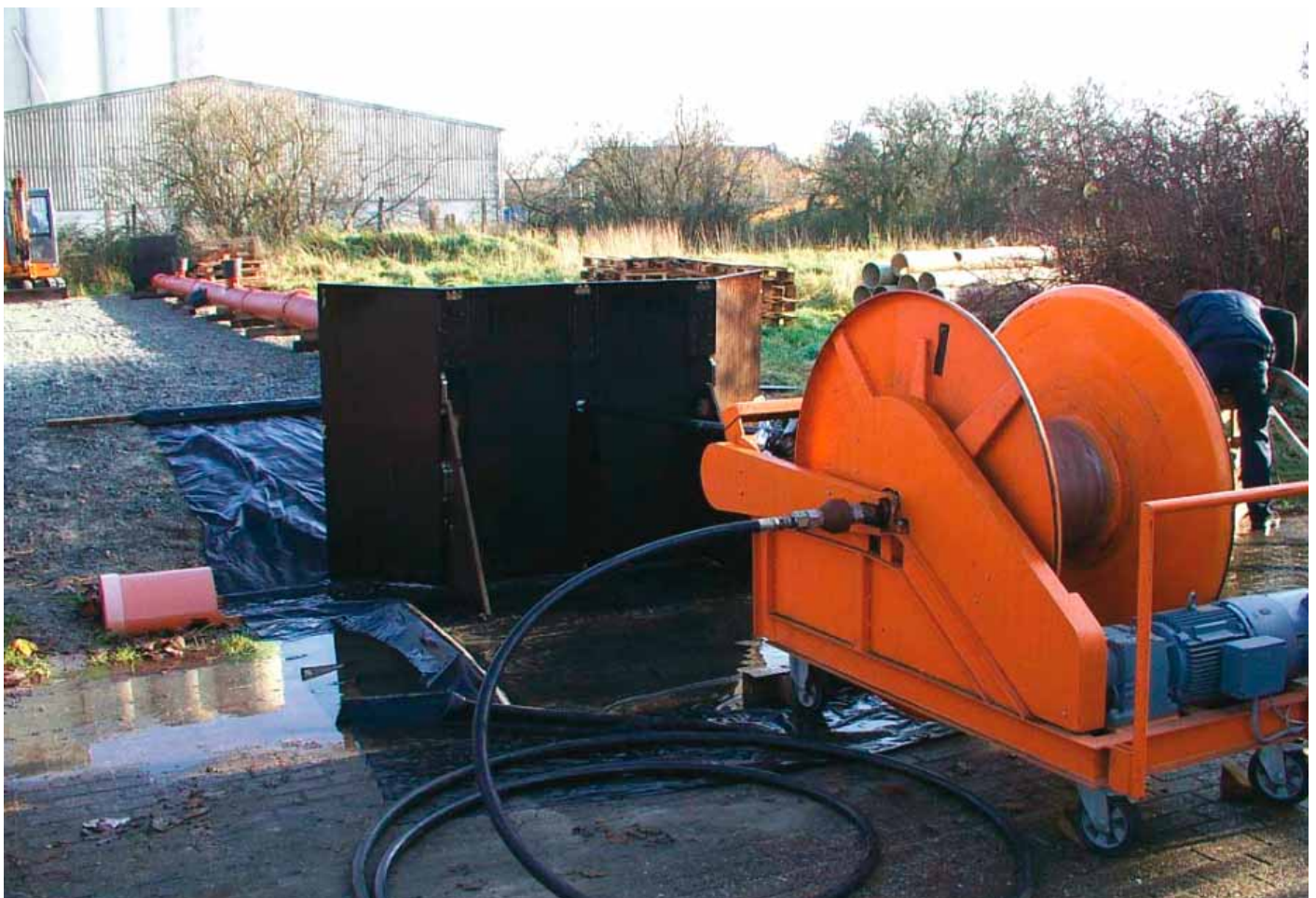
Schlauchhaspel im Einsatz bei Verfahren 2 (Praxisprüfung)
